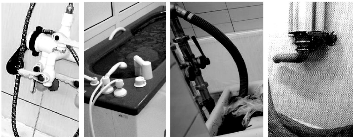
instalații de furnizare a nămolului în sala de terapie
